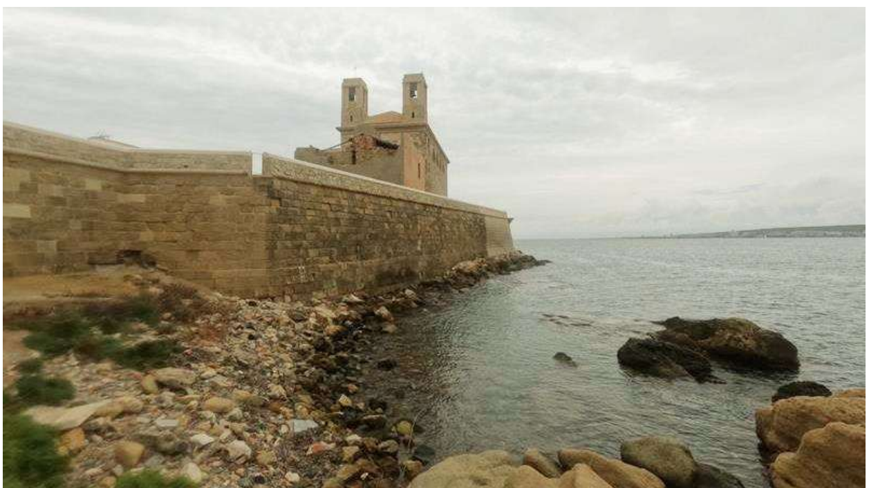
Fotografía 3-19. Aspecto de la muralla en la cara norte, con grandes bloques de escollera.
