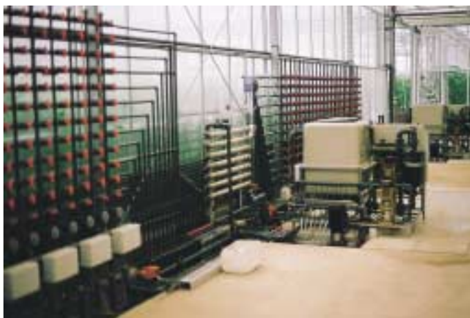
48. Sistema de desinfección de drenajes con lámparas de radiación. UV.
