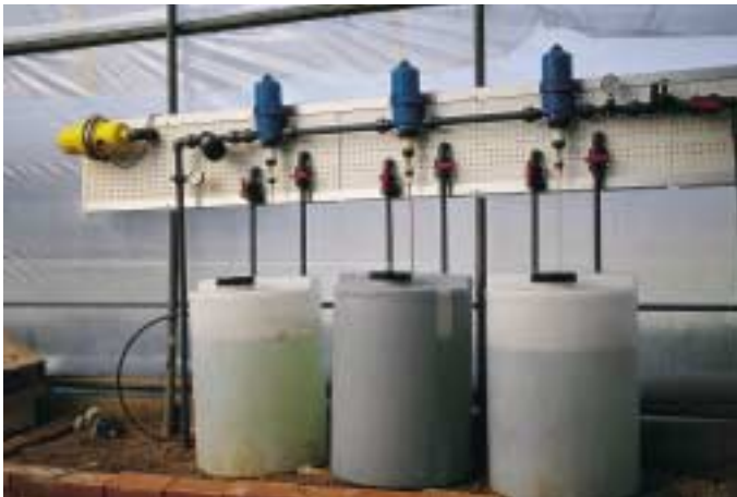
21. Cabezal de riego con inyección proporcional. Fundación Caja Rural Valencia.
