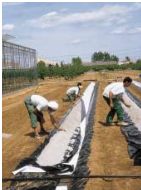
11. Instalación de salchicha de arena para cultivo de melón al aire libre en Fundación Caja Rural Valencia.
