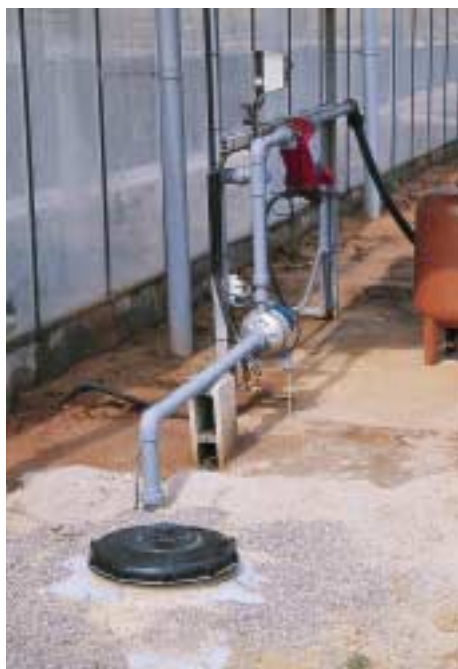
47. Dispositivo formado por depósito enterrado de recogida de drenaje, sistema de bombeo y filtrado automático para aprovechamiento del drenaje en cultivo de hortalizas al aire libre. Fundación Caja Rural Valencia.
