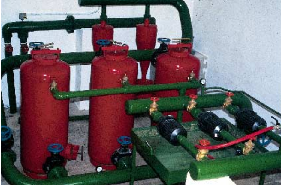
Foto 2. El filtrado es fundamental para el buen funcionamiento de la instalación.
