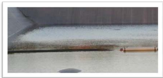
Figura 1 Les bombolles indiquen la presència d'aigua o aire davall de la làmina (o revestiment). Si es formen bombolles més grans, això pot portar a la ruptura de la làmina. L'aigua davall de la làmina també pot danyar els dics (Font: PSKW).
