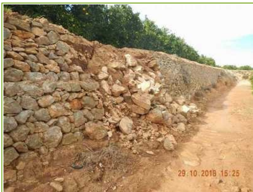
Ensulsiada de murs de contenció a Pedralba. Font: OCA el Camp de Túria.
