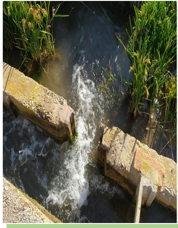
Renovació d'aigua en parcel·la d'arròs Font: OCA de Carlet
