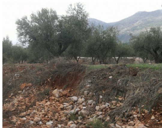
Desprendimiento bancal (El Comtat). Fuente: OCA .
