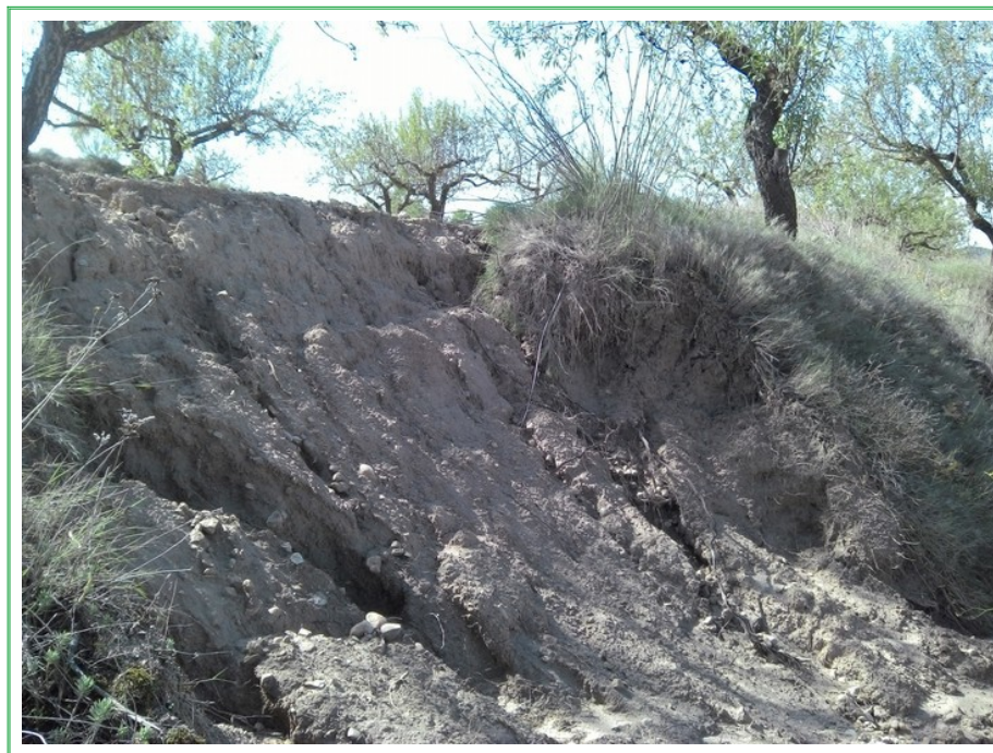
Daños en ribazos en municipio de Moixent. Fuente: OCA: la Costera-Xàtiva
