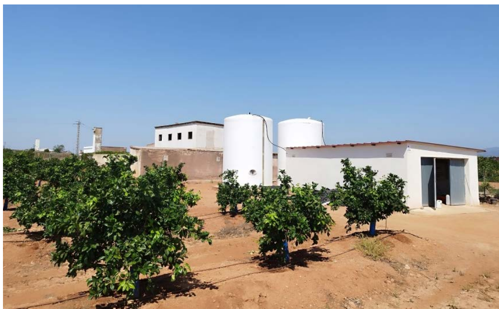
Imagen izquierda, depósitos de almacenamiento de agua en parcela.
